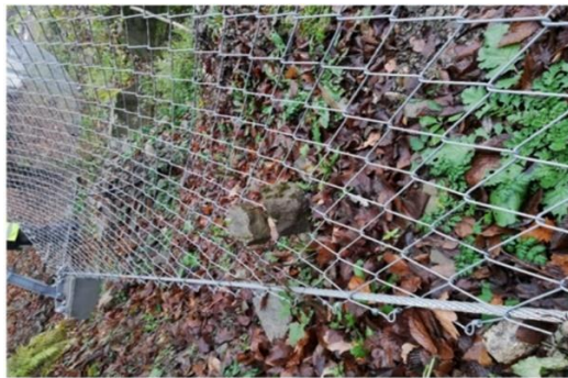
Rysunek 27. Pierwsze małe odłamki skalne przechwycone przez barierę na DW948 na odcinku od km: 30+590,00 do 30+630,00 [fot. W. Błaszczyk]
