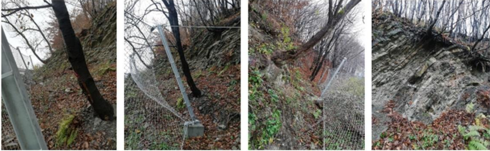
Rysunek 26. a, b, c, d Zbocze przy DW948 na odcinku od km: 30+590,00 do 30+630,00 [fot. W. Błaszczuk]
